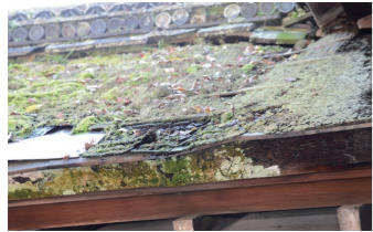
木部まで水が廻り腐食が進行した西渡廊檜皮屋根
