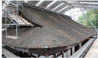
腐朽した檜皮屋根
